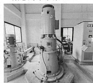
畑岡揚水機場 (栗原市若柳地内) 電動機(75kw) 更新N=1台
