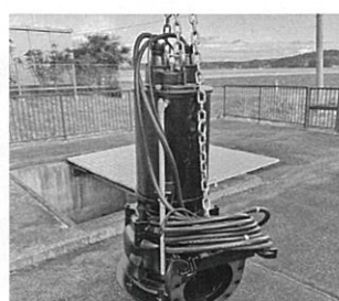
土手前揚水機場 (登米市石越町地内) 着脱式水中ポンプ (φ300×37kw)更新N=1台
