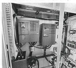
内の目揚水機場 (登米市石越町地内) インバータ(37kw,15kw) 更新N=2台
